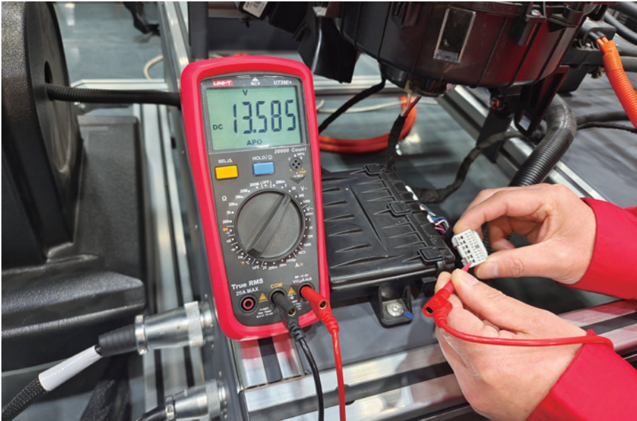
图 6-3-12 空调控制器 G21 (A) 插头的 1 号端子电压测量
